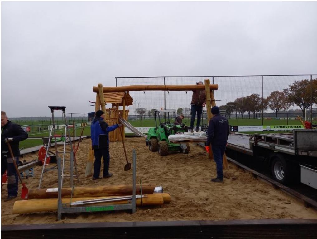
De firma Speelmaatje druk bezig met plaatsing van speeltoestellen in de zandbak.
